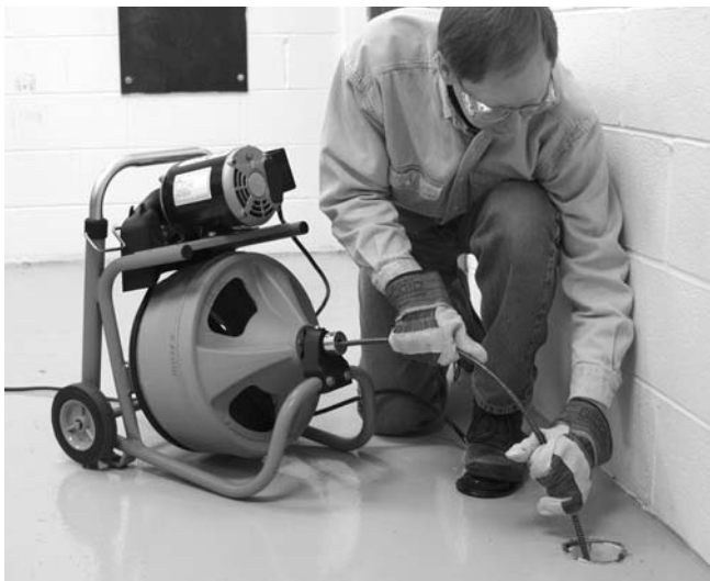
Figura 12 – En posición correcta para trabajar: operario se encuentra alimentando el cable manualmente
